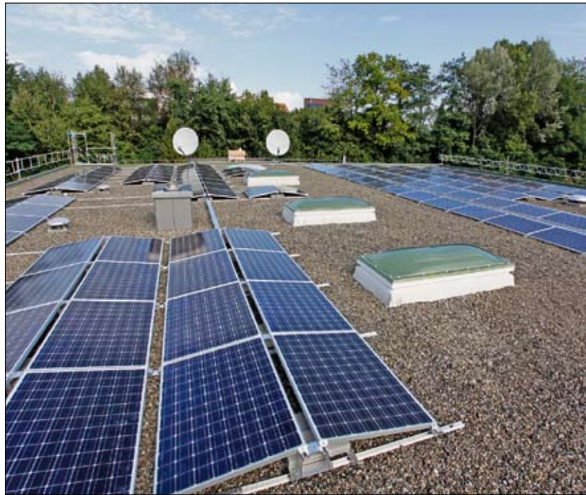
Die Photovoltaikanlage auf dem Dach der Localnet AG in Burgdorf.
